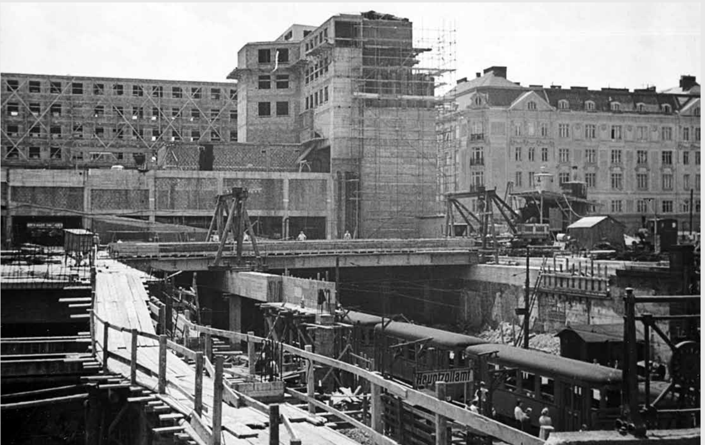
Der Neubau des Bahnhofes und der Haltestelle Hauptzollamt, die am 18. Jänner 1962 in Landstraße umbenannt wurde, ist um 1960 bereits weit fortgeschritten. Rechts erkennt man die provisorische Station der Stadtbahn. Foto: Sammlung Michael Weininger.
