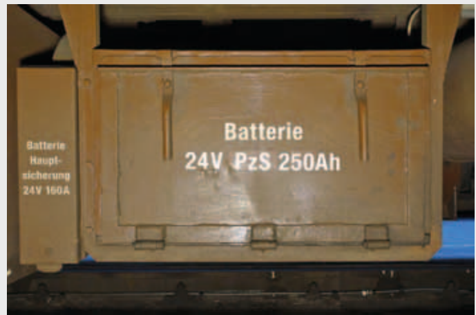
Batteriekasten mit Batteriehaupsicherung ET 10.104. (Robert Köfler)
